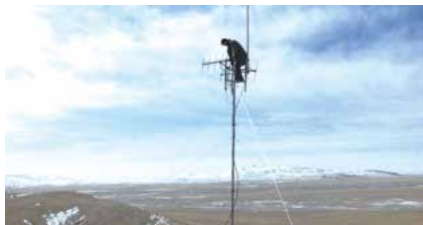
2016年5月8日，格尔木市分公司技术人员在班德湖调整直放站天线
