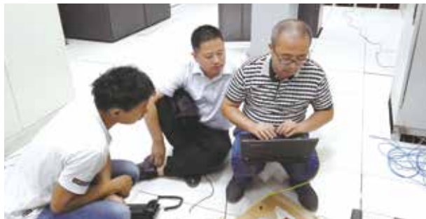
2016年9月19日深夜，贵州省黔南布依族苗族自治州平塘县分公司员工在 FAST 机房调测电路
